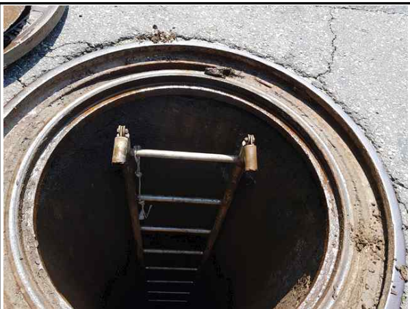
내용 추락방지시설 안전손잡이 파손
