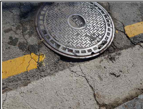
내용 도로포장 아스콘파손
