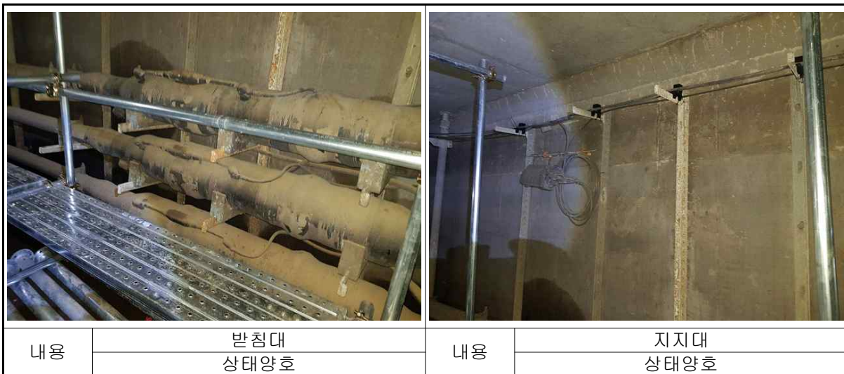
【사진 6.12】 부속 및 부대설비 현황
