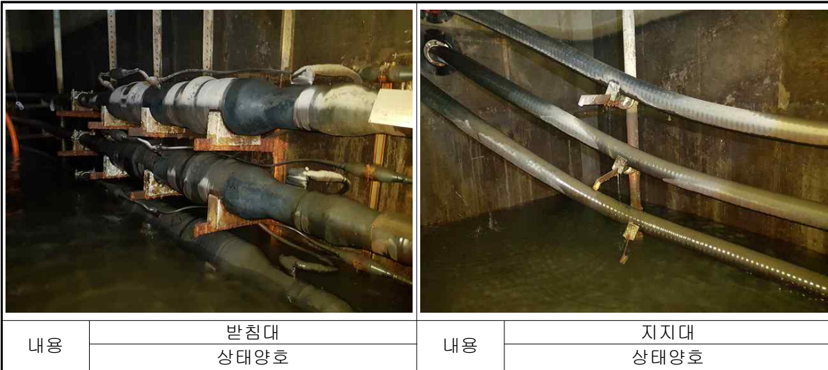
【사진 6.4】 부속 및 부대설비 현황
