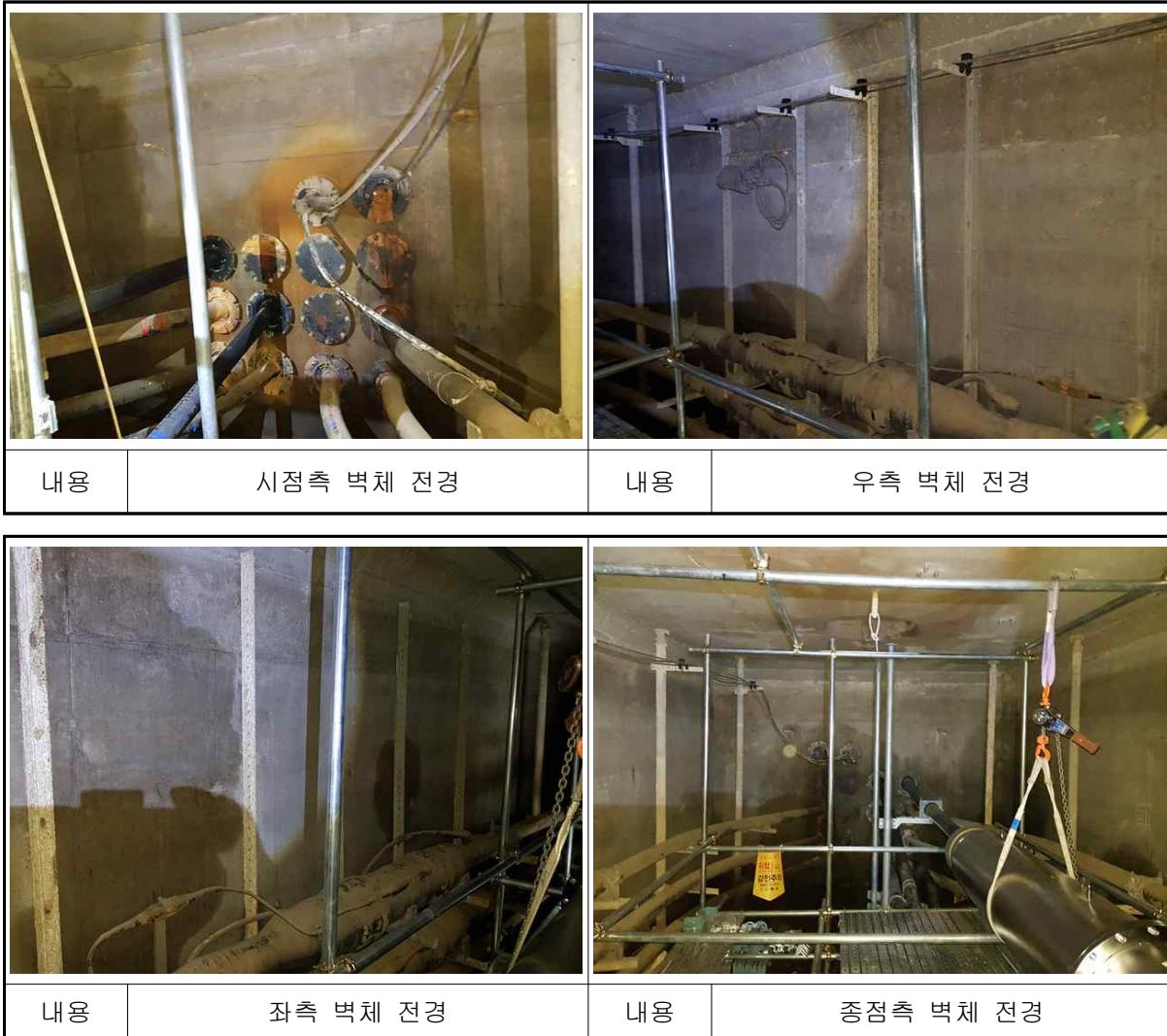
【사진 6.9】 문산~선유 #3 전경
