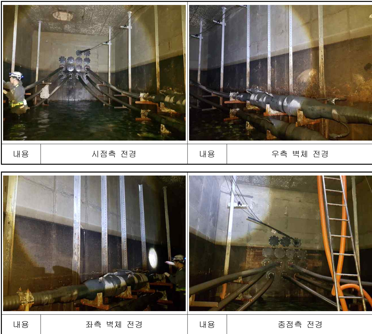
【사진 6.1】 문산~선유 #1 전경
