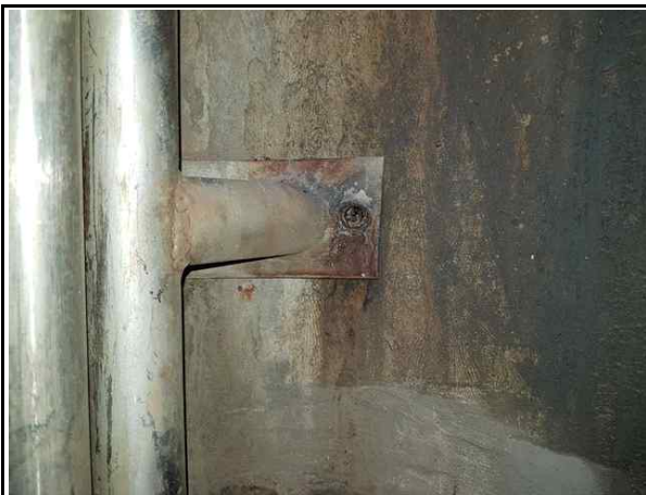
내용 추락방지시설 앵커볼트파손
