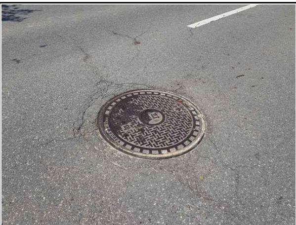
내용 도로포장 아스콘망상균열
